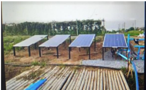
ระบบโซลาร์เซลล์
