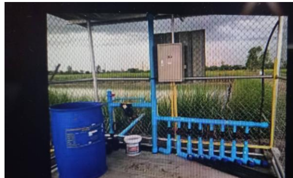
ระบบควบคุมน้ำ
