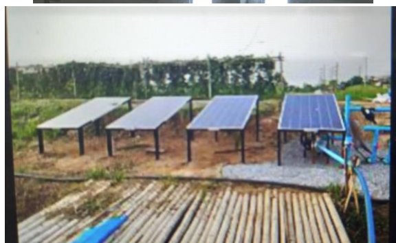
ระบบโซลาร์เซลล์
