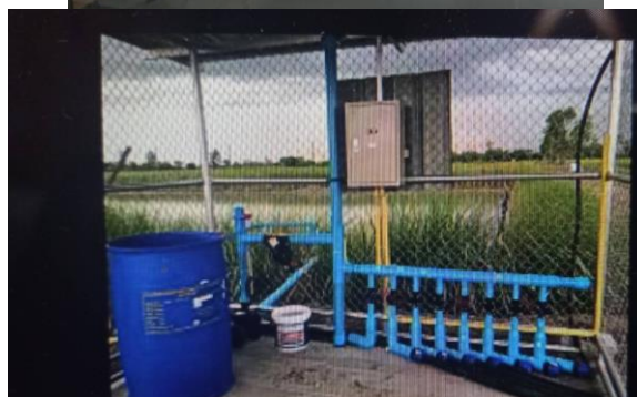
ระบบควบคุมน้ำ
