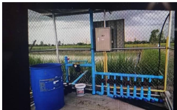
ระบบควบคุมน้ำ
