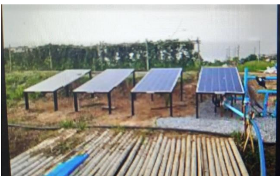
ระบบโซลาร์เซลล์
